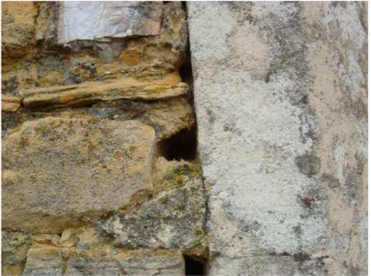
photo 7 : joints de maçonnerie absents.
