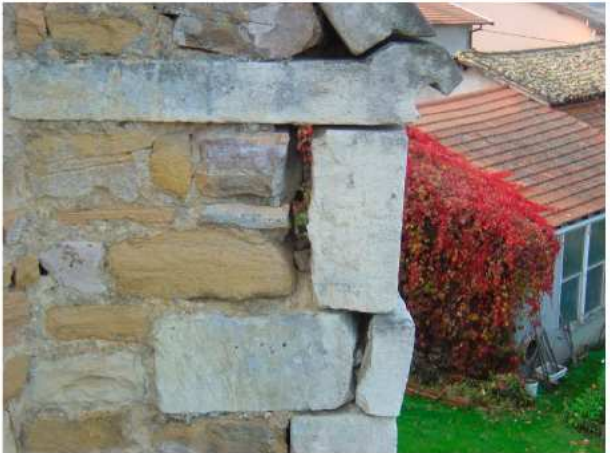
photo 27 : déjoints et début de basculement des pierres de couverture d'un contrefort situé à l'arrière de l'église.
