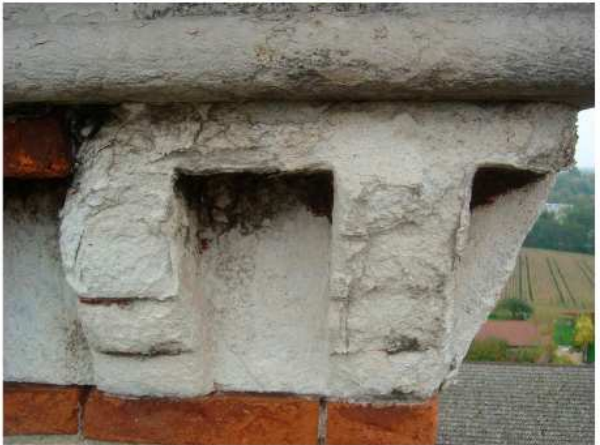
photo 13 : pierre d'angle fortement dégradée par le gel.
