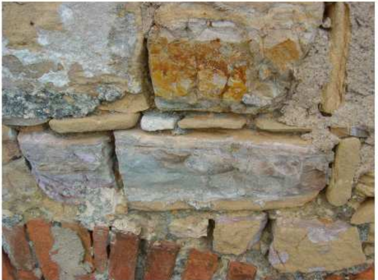
photo 5 : joints de maçonnerie pulvérulents ou manquants.
