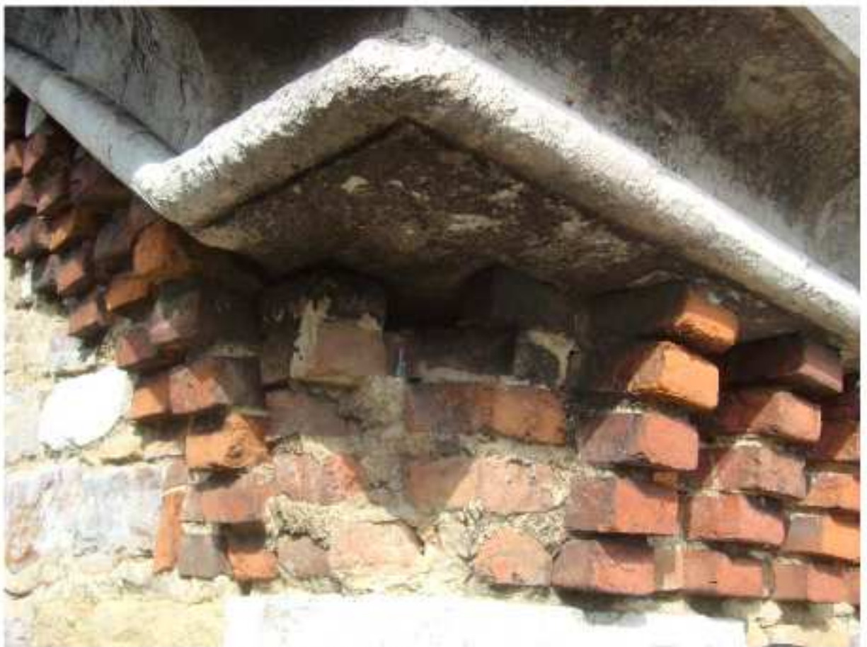
photo 22 : briques manquantes dans un angle.
