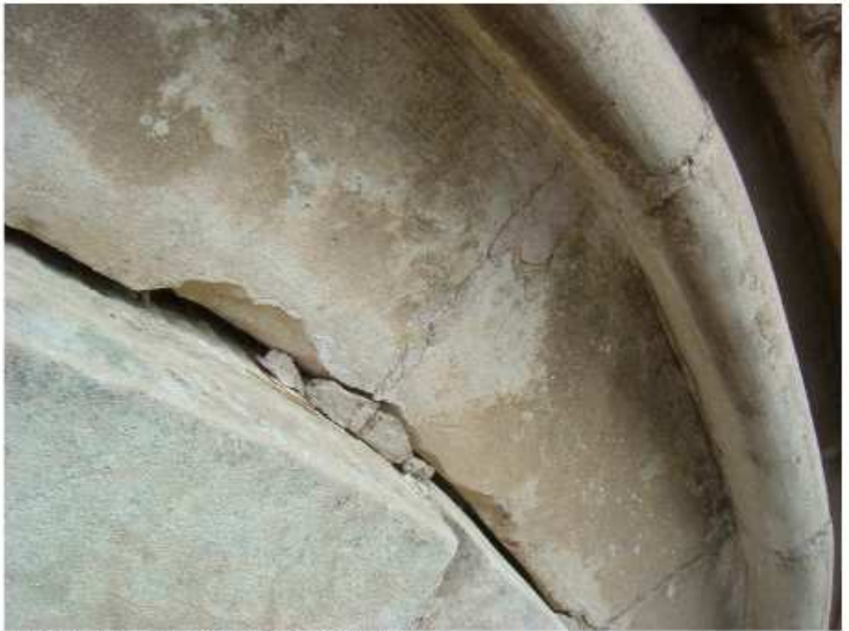
photo 11 : pierre cassée au niveau du portail.
