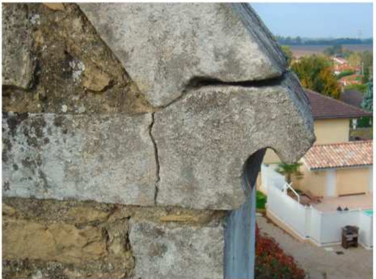
photo 28 : fracturation d'une pierre supportant une pierre de couverture d'un contrefort.
