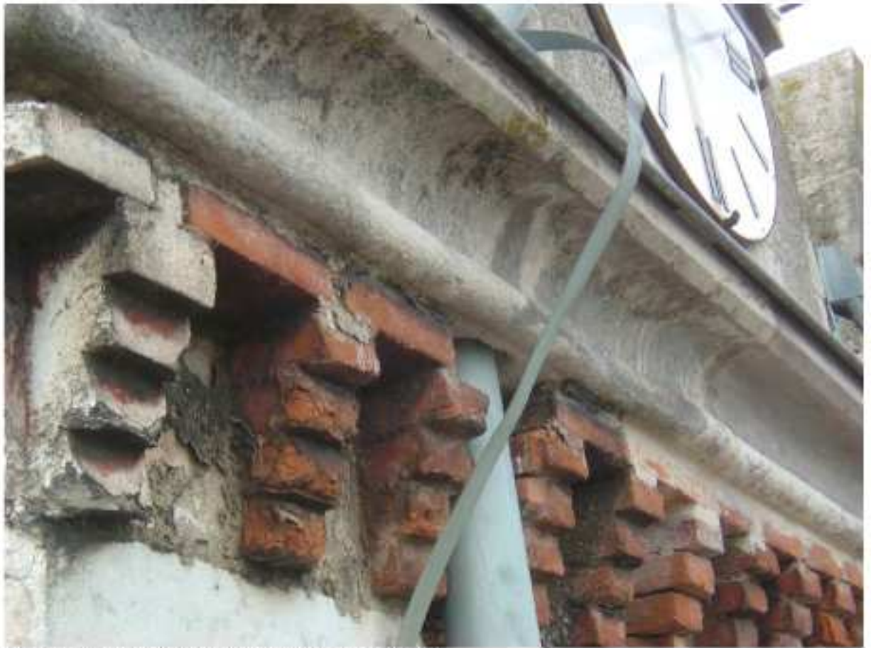
photo 17 : dégradation des briques (gel – dégel).
