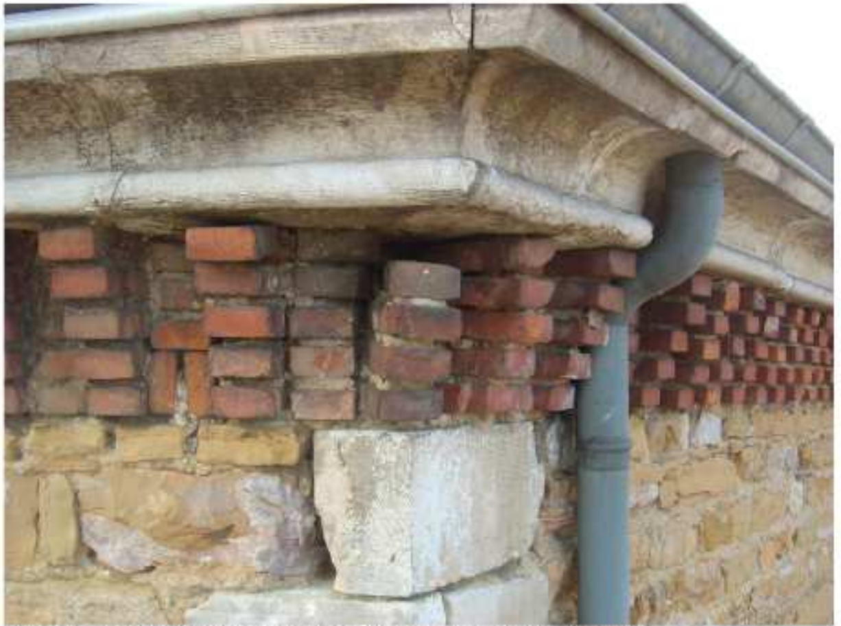
photo 23 : briques menaçant de tomber dans l'angle de l'église côté cure.
