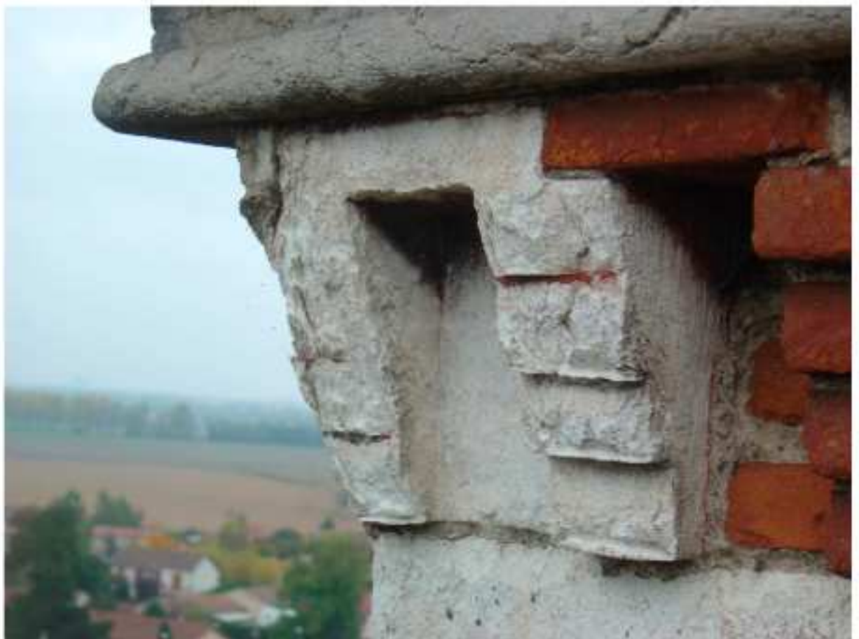
photo 14 : pierre d'angle fortement dégradée par le gel.
