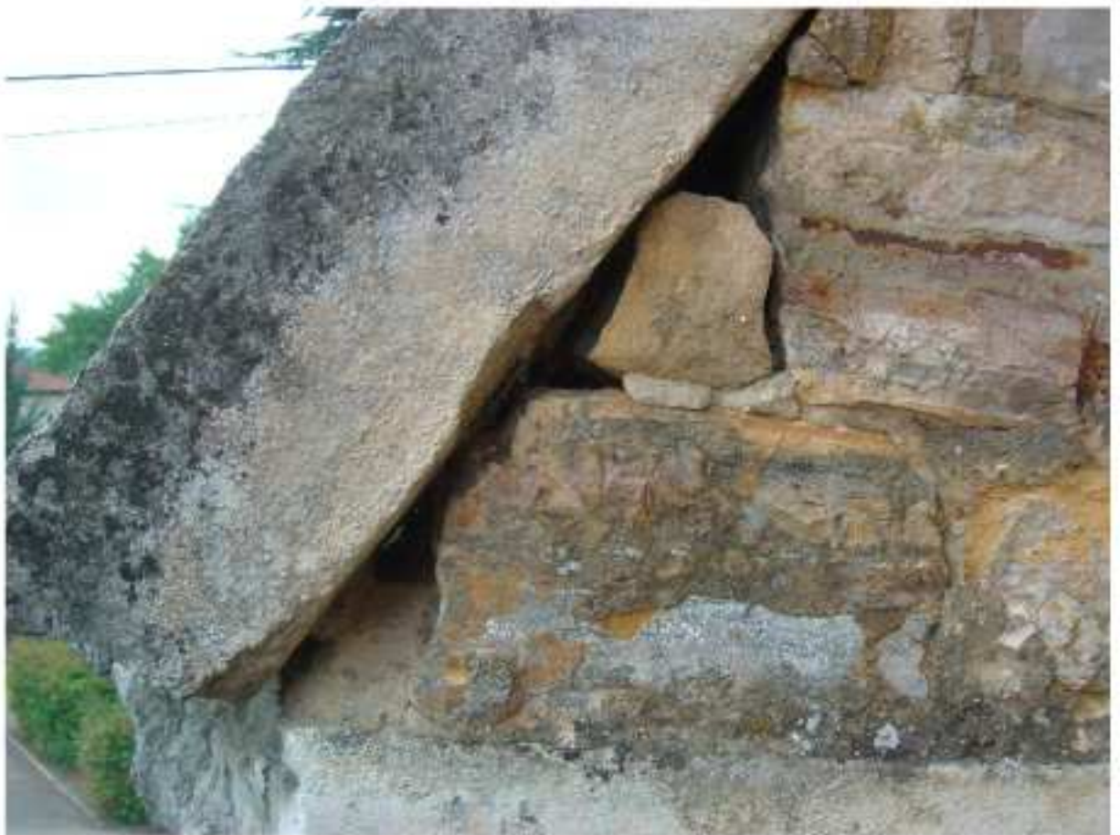
photo 26 : déjointoiement d'une pierre de couverture d'un contrefort.
