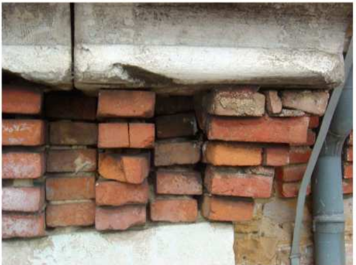
photo 20 : disparition du joint des briques.
