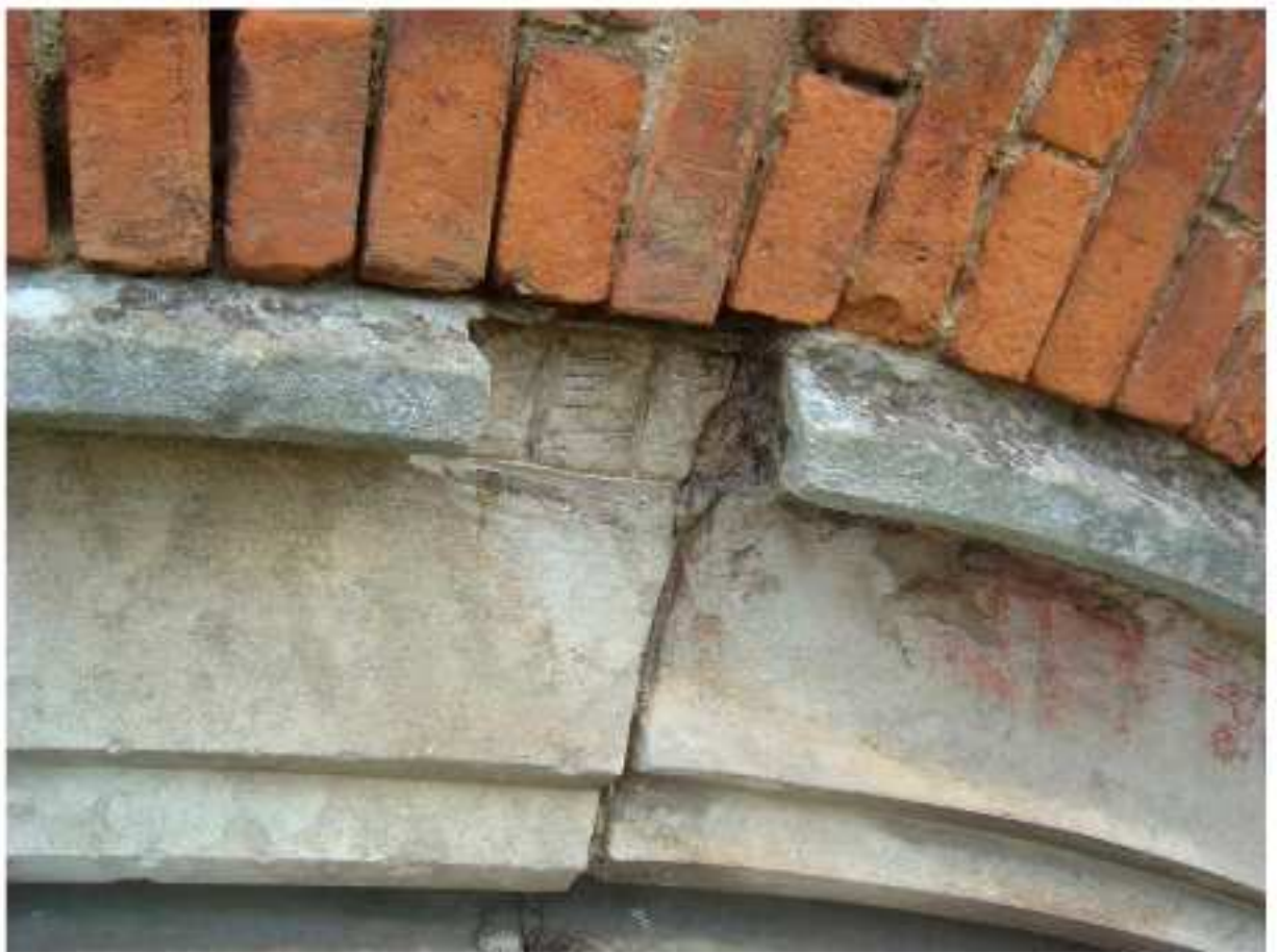
photo 10 : pierre cassée au niveau du portail.
