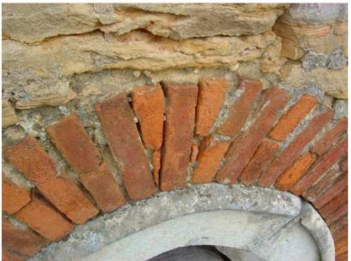
photo 6 : joints de maçonnerie et de briques manquants.
