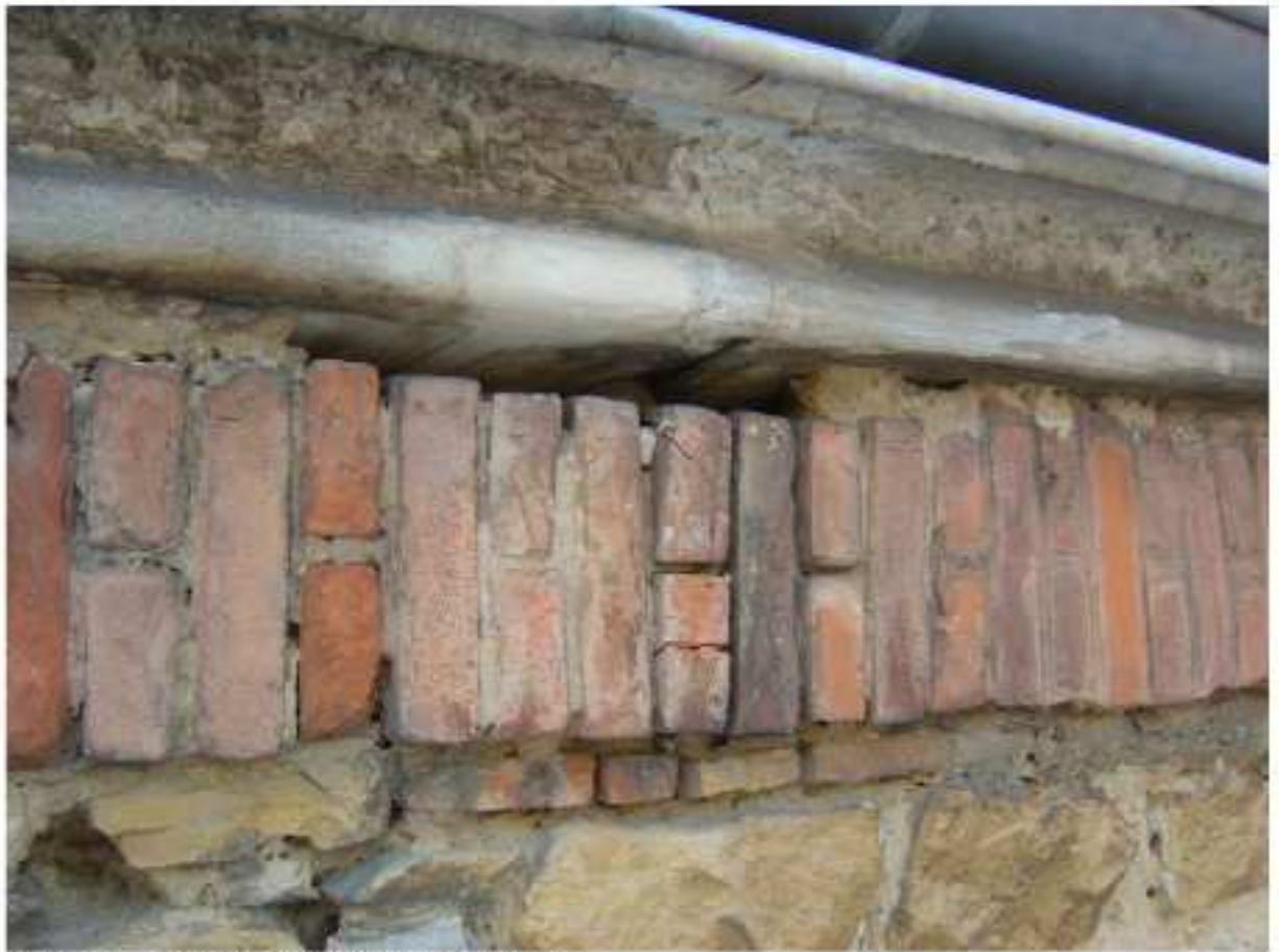
photo 21 : disparition du joint des briques.
