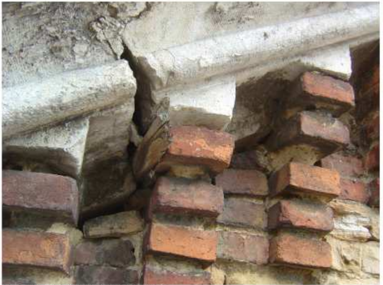
photo 19 : disparition du joint des briques.
