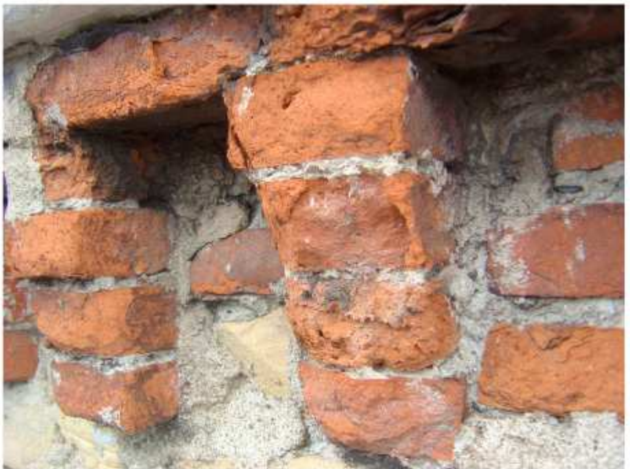
photo 16 : dégradation des briques (gel - dégel).
