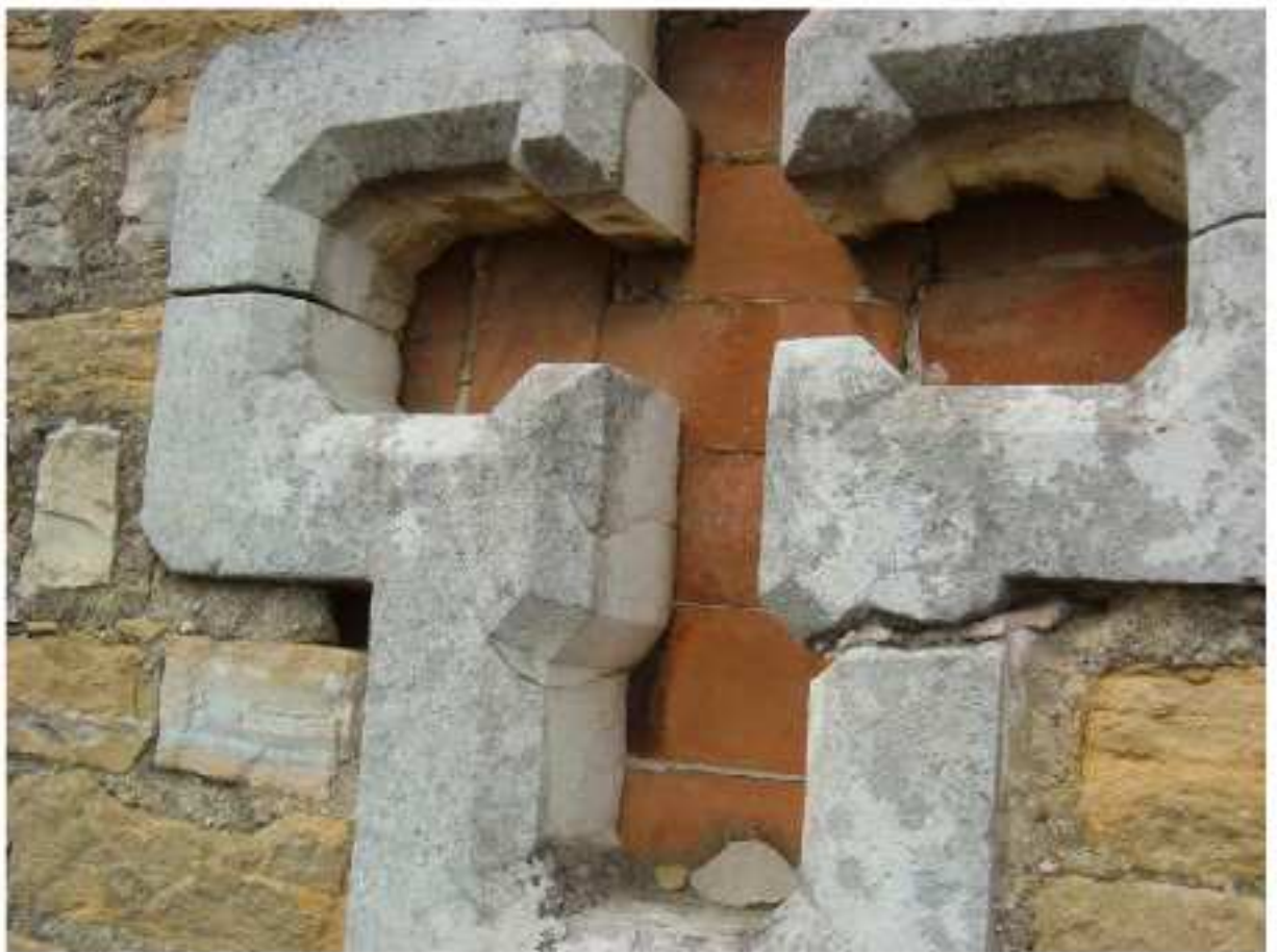
photo 12 : pierres cassées au niveau d'un fenestron.
