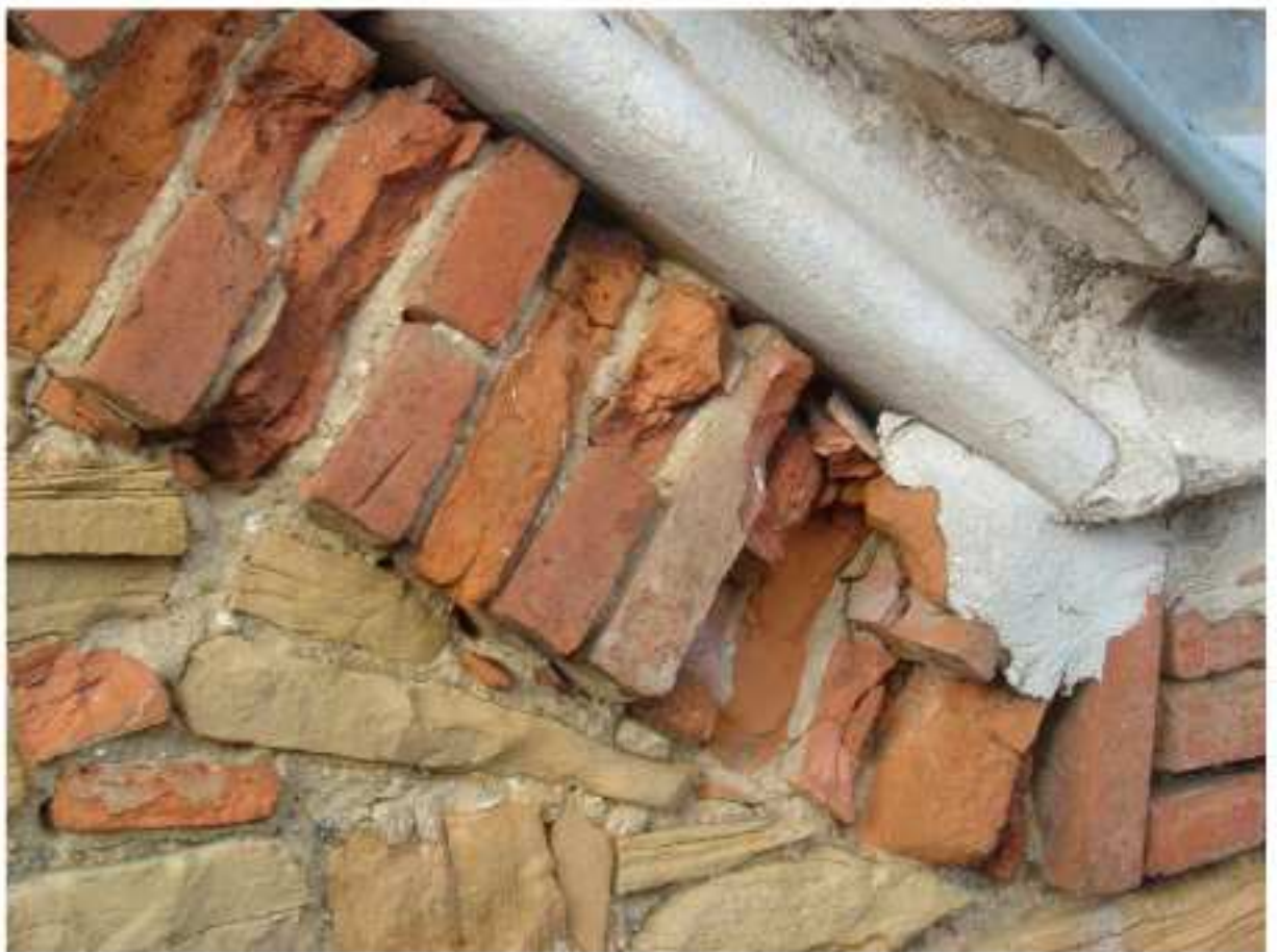
photo 18 : briques fracturées par le gel.
