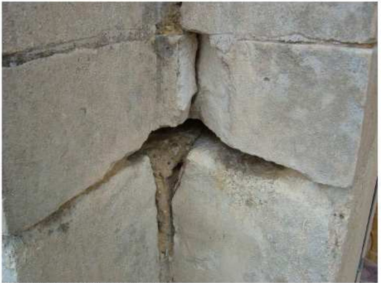
photo 9 : absence de joints de maçonnerie.
