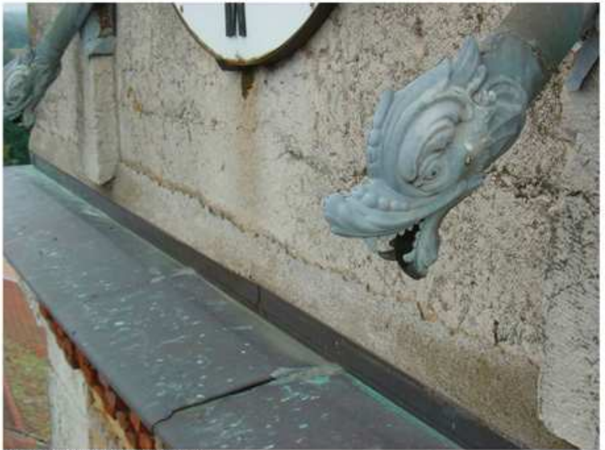
photo 3 : décollement de l'enduit.
