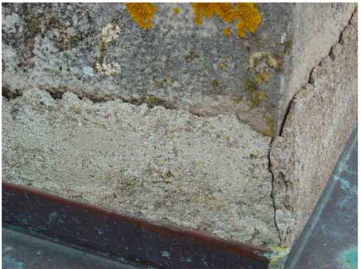
photo 4 : enduit décollé et fissuré.
