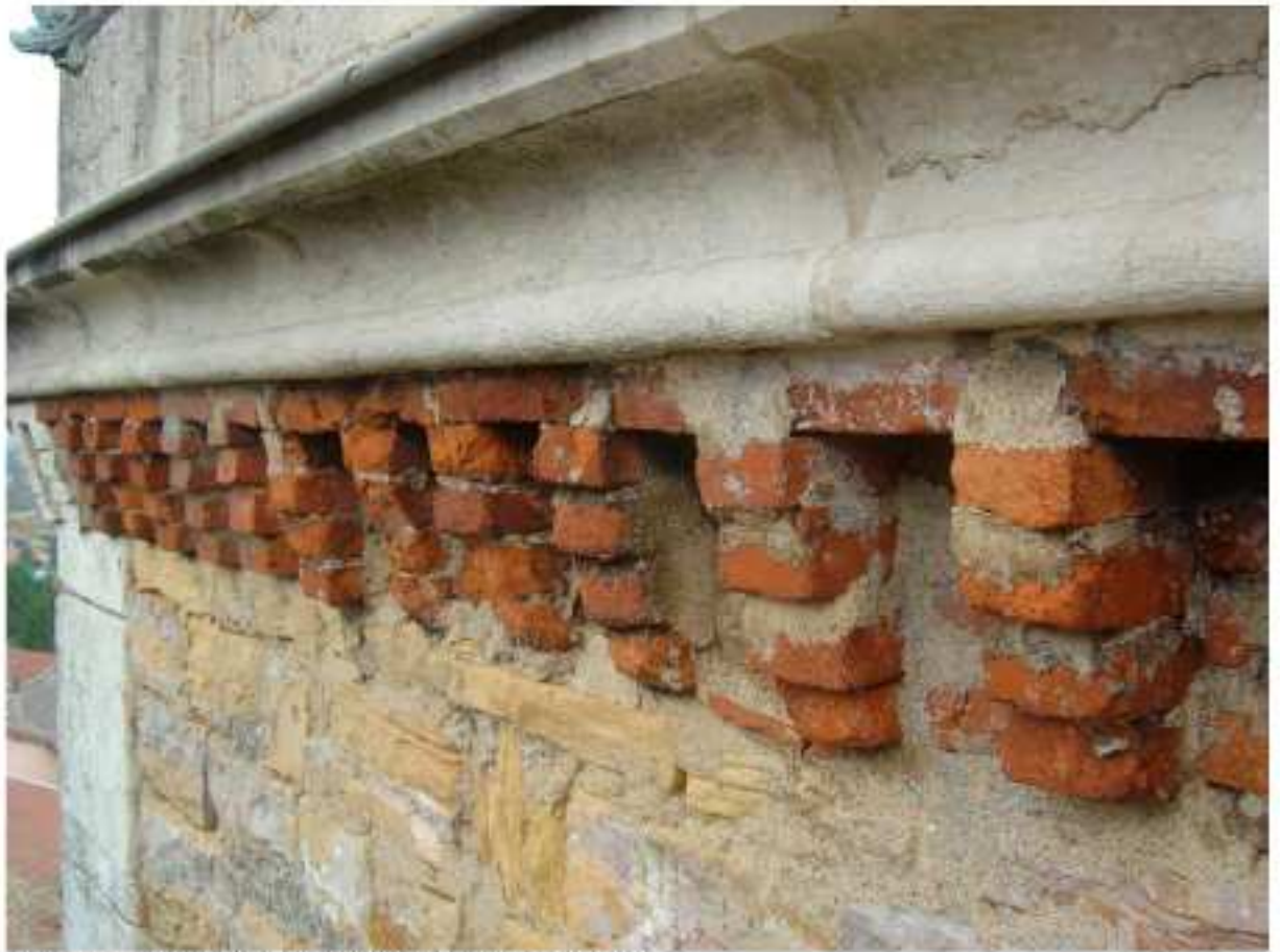
photo 15 : dégradation des briques (gel - dégel).
