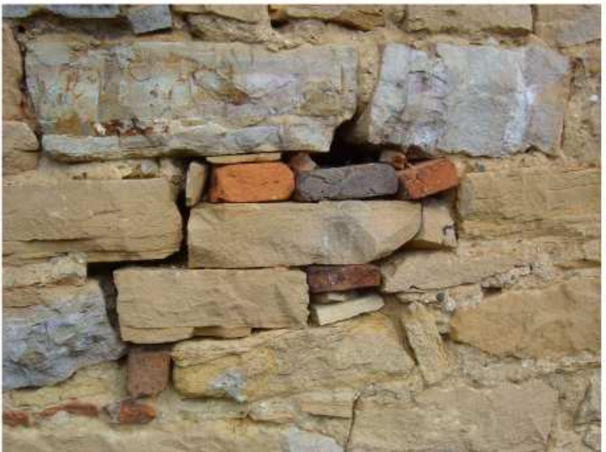
photo 8 : absence de joints de maçonnerie.
