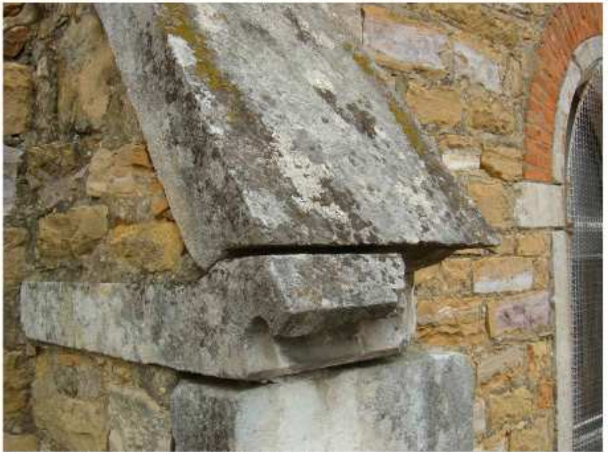
photo 25 : pierre couverture d'un contrefort fracturée.
